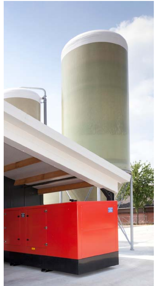
Bei einem etwaigen Stromausfall kommt das leistungsstarke Notstromaggregat zum Einsatz.
