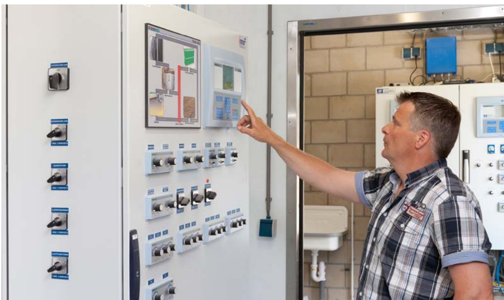
Die Steuerung der gesamten Stallklima-technik erfolgt vollautomatisch per Computer.
