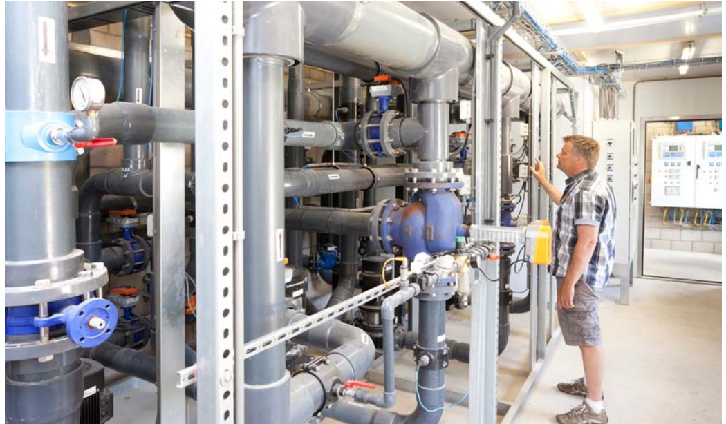
Das Herzstück der Anlage ist die Wärmepumpe zum Heizen und Kühlen des Stalles.
